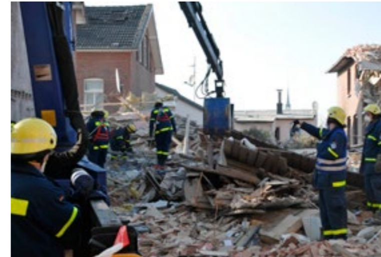
Vorsichtige Erkundung der Trümmer nach Gasexplosion in Itzehoe
