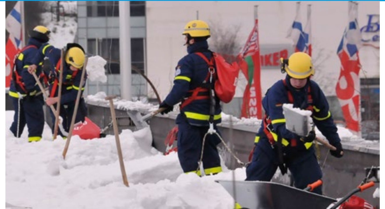
2010 mussten viele Kieler Dächer von Schnee befreit werden um nicht instabil zu werden
