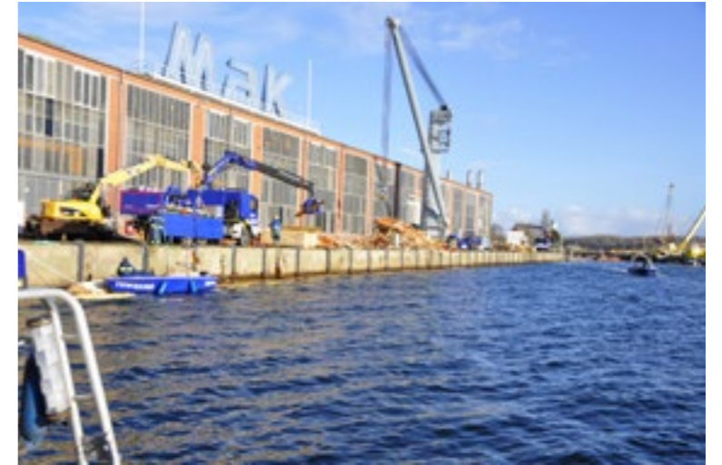
Holzschlagplatz an der Kaianlage der MAK in Friedrichsort
